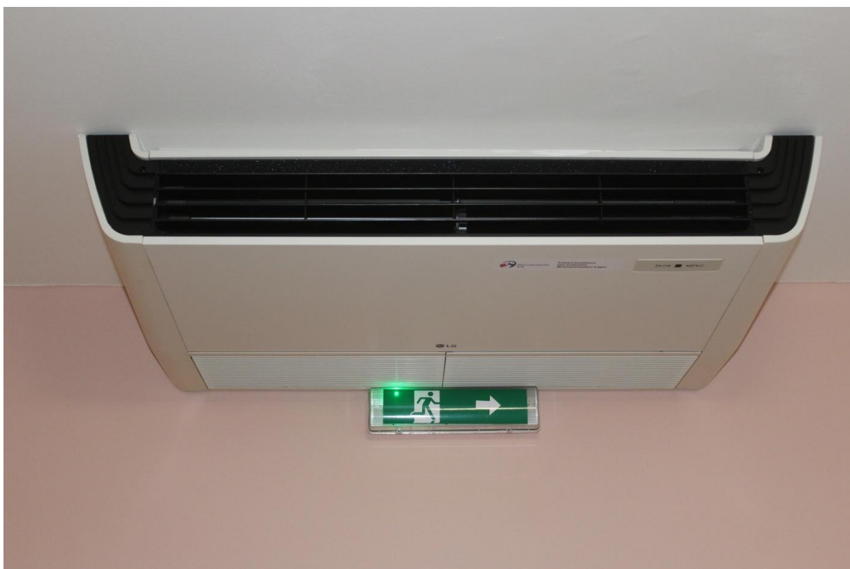
Klimatizační jednotka v jídelně
